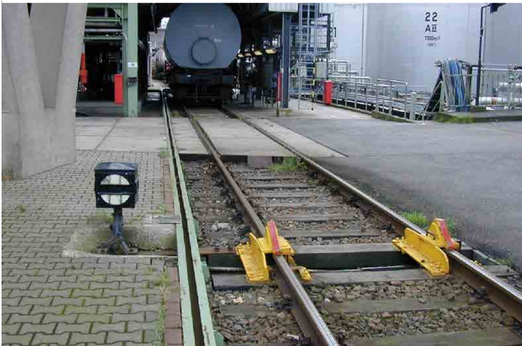
Fig. 6 Gleissperre, die das Hineinfahren der Propylenoxid Beladestation verhindert
